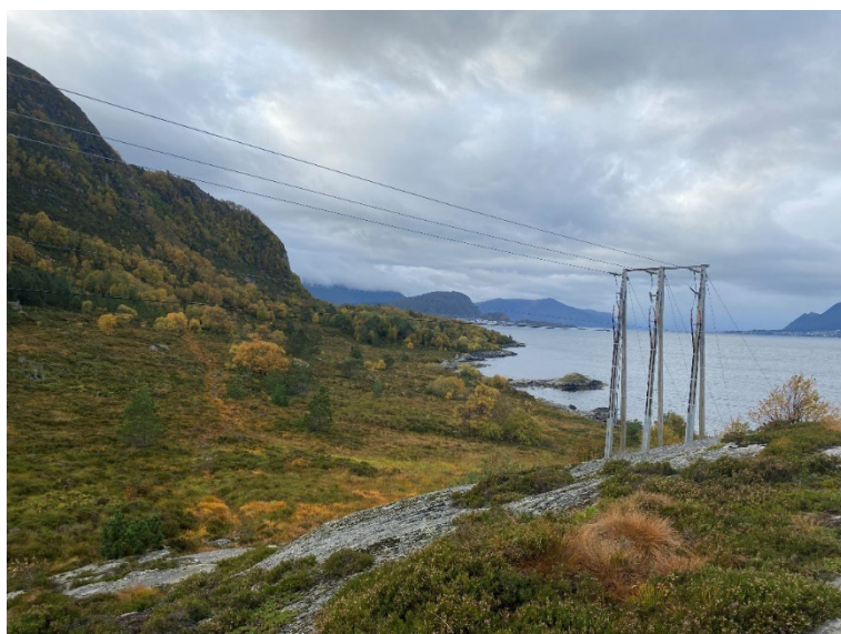
Figur 20: Vestleg endepunkt for høgspenningslinja. Sett mot sørvest.
